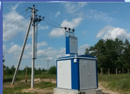
Подстанция. Понижающий трансформатор.
