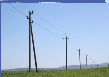
Низковольтная линия передачи электроэнергии
