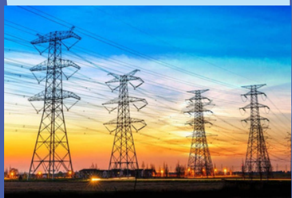
Высоковольтная линия передачи электроэнергии
