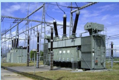
Подстанция. Повышающий трансформатор.
